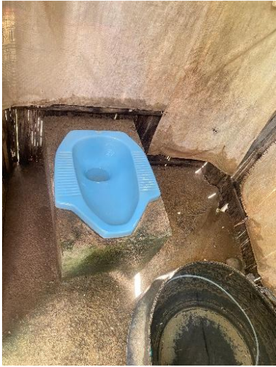
Gambar 5. Kondisi lantai jamban
