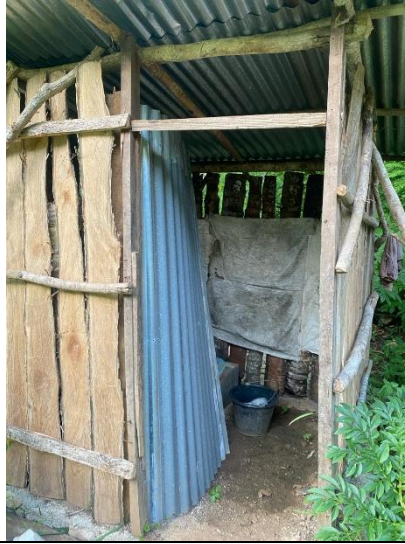
Gambar 6. Kondisi bangunan jamban tidak memenuhi syarat
