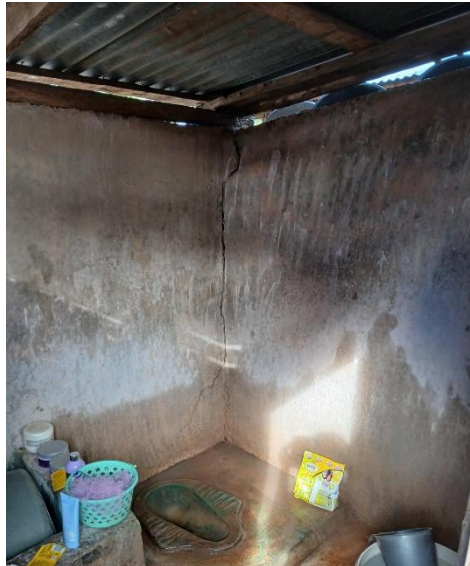
Gambar 4. Kondisi dinding jamban dan ventilasi jamban
