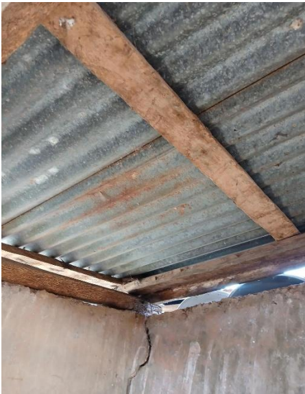
Gambar 3. Kondisi atap jamban
