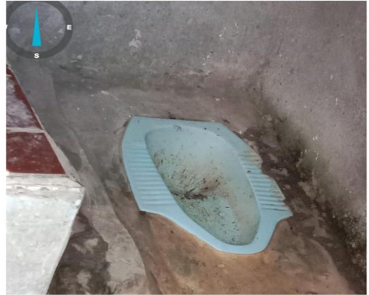
Saluran jamban tidak mudah gelontor (tersumbat)
