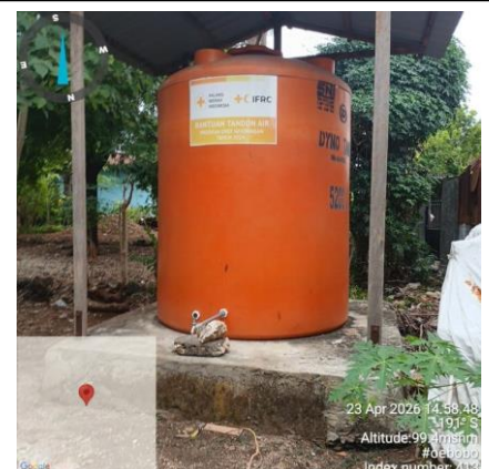
Dokumentasi sarana air bersih masa kekeringan
