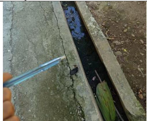
kondisi pembuangan air limbah
