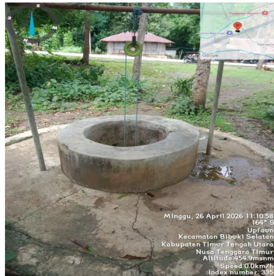
Kondisi Sumur Gali
