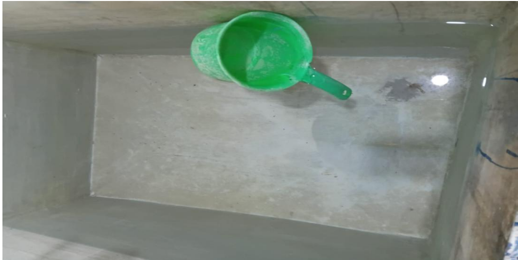
Gambar 8. Bak mandi yang tidak di kuras
