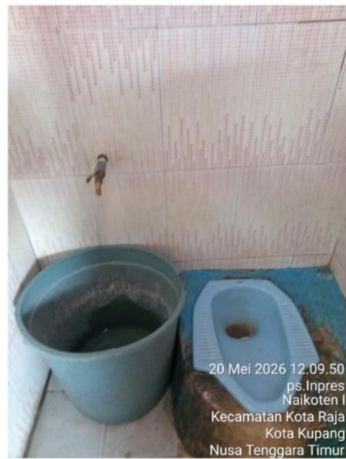
Kondisi jamban Pasar Kasih
