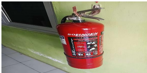
Gambar 16.11 Tersedia alat pemadam kebakaran di depan ruangan pelayanan
