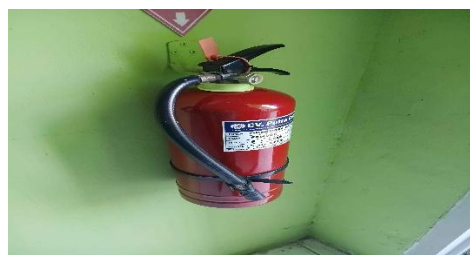
Gambar 15.12 Terdapat alat pemadam kebakaran di luar ruangan gudang farmasi
