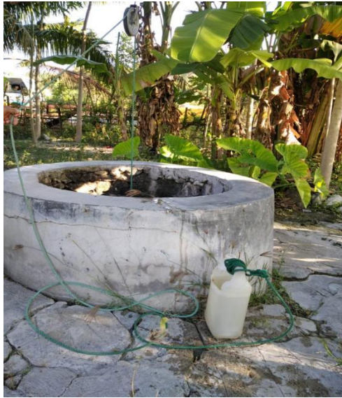
Kondisi Dinding, Lantai, Dan Ember Timba
