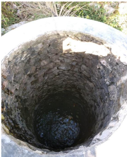
Kondisi Sumur Gali
