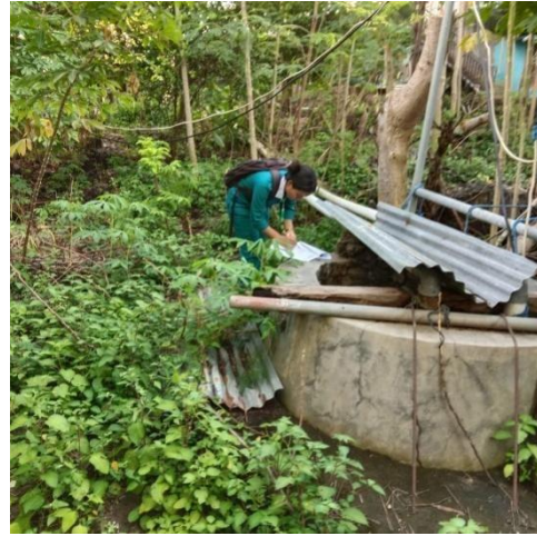
Inpeski Kondisi sarana sumur bor 2
