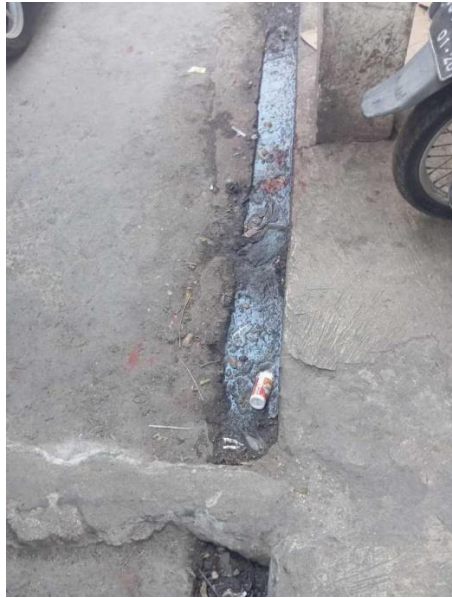
Saluran pembuangan air limbah (drainase)
