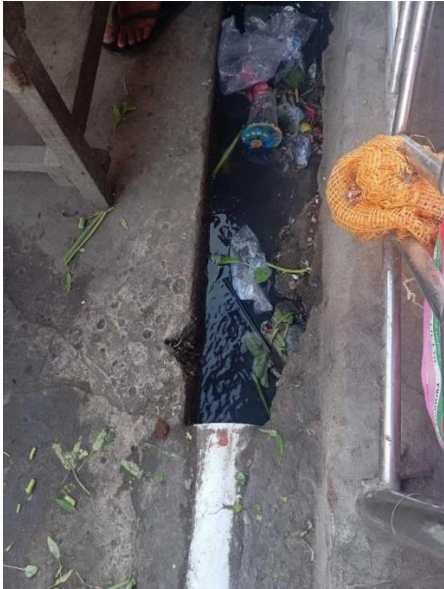
Saluran pembuangan air limbah (drainase)
