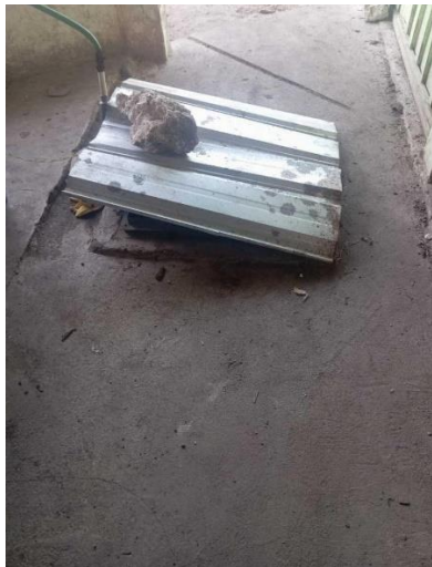
Bak penampung air
