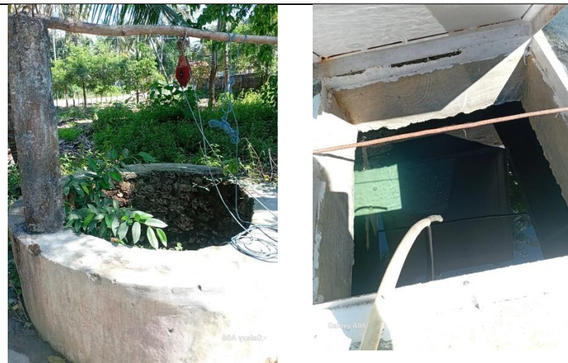
Gambar 2: kondisi sarana air bersih Di Desa Manulai I
