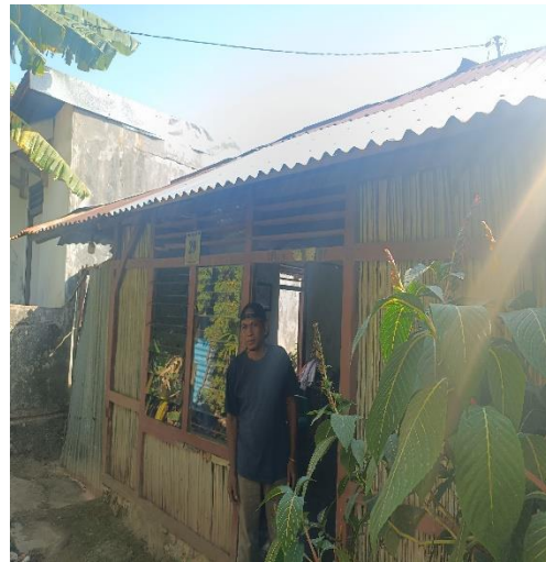
Rumah yang ada sarana sanitasi tetapi tidak memenuhi syarat
