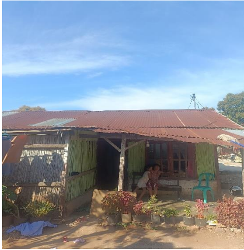
Rumah yang tidak ada sarana sanitasi Pembuangan Air Limbah
