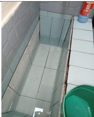
Bak mandi yang tidak di kuras
