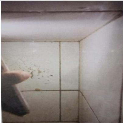
Bak mandi yang tidak di kuras
